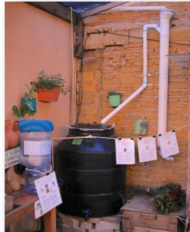
Sistema de captación de lluvia en zona urbana con filtro cerámico en Vía Orgánica
