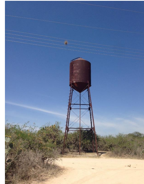
Tanque elevado de la comunidad-vacío por años
